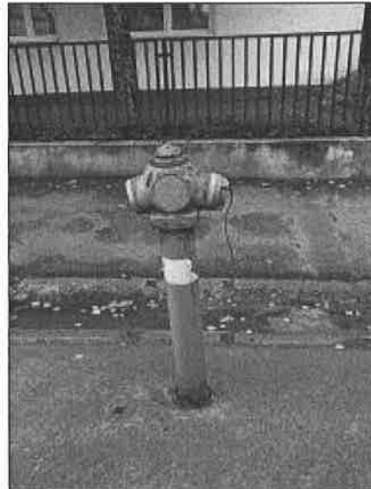
Köztársasági úton föld feletti tűzcsap
