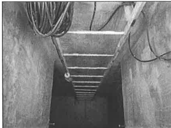
Nyersvíztároló és szűrtvíztároló medence
