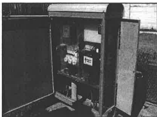
24. kép: DÁ-M-III.-as átemelő - elektromos szekrény
